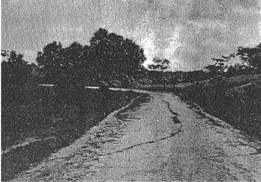
Foto 33 Red vial. grietas en diferentes puntos.
