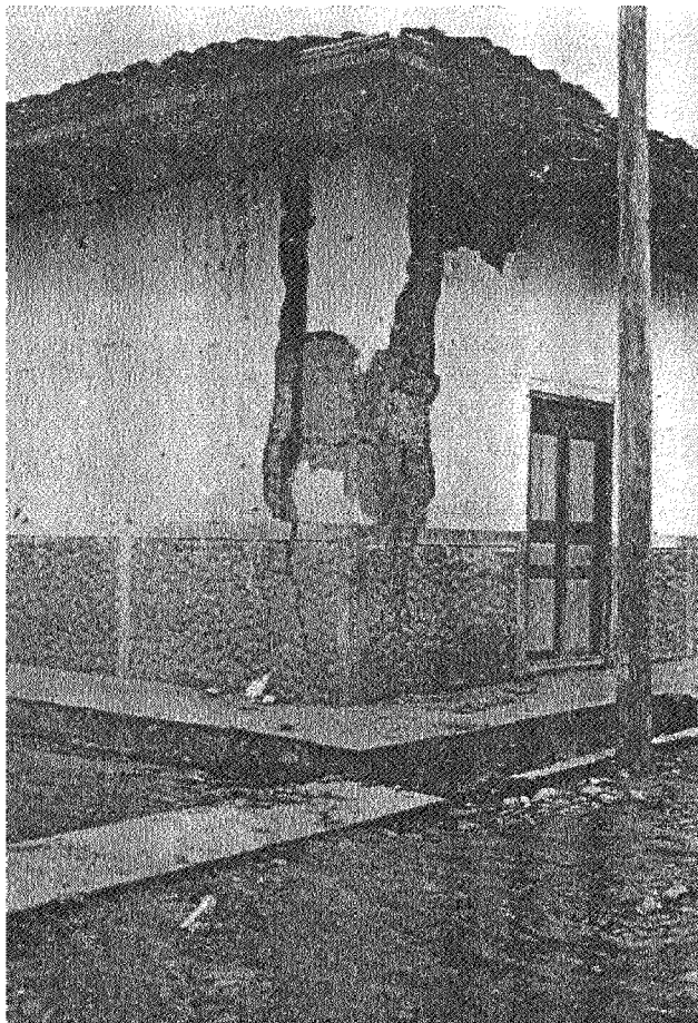
Foto 13 Vivienda de tapial, con agrietamiento en esquina
