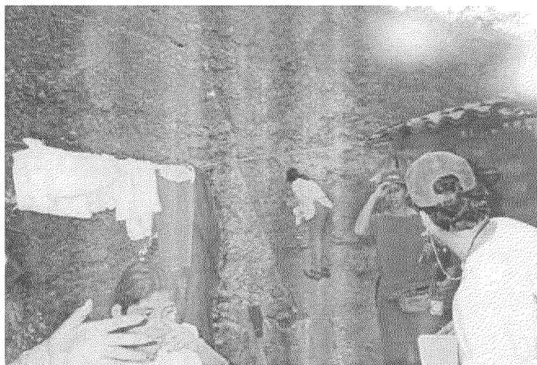
Corte de talud casi vertical en el Barrio El Progreso
