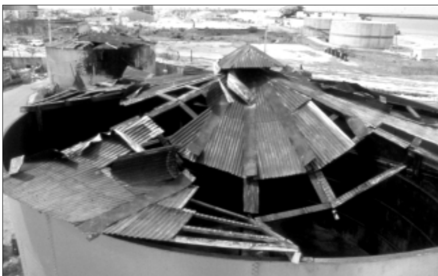
Pérdida de techo en estanque de almacenamiento debido a huracán
