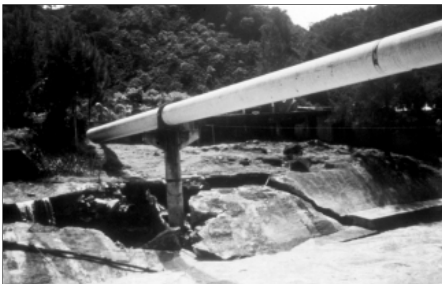
Daños provocados en protecciones de puente para paso de tubería de línea de conducción Orosi, Costa Rica, octubre 1999. Concreto desplazado: peso 500 toneladas.
