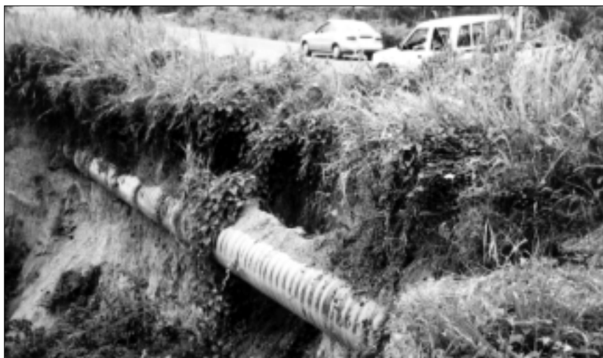
Las obras de prevención reducen la vulnerabilidad de los sistemas. Tubería expuesta, Ecuador
