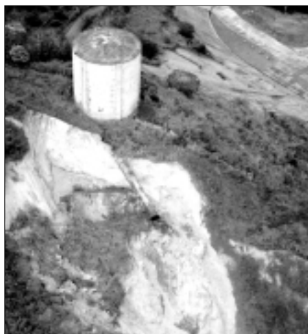
Deslizamiento en tanque de almacenamiento
